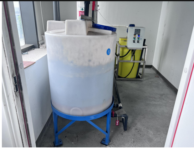
废水处理设施现状
